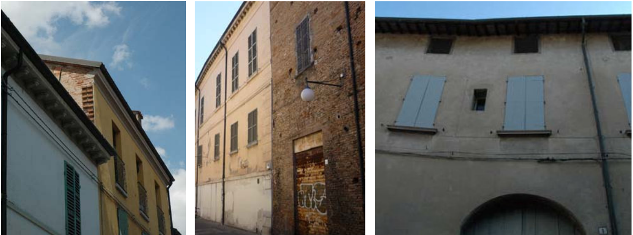
Fig.11: Esempi di caratteristiche costruttive ricorrenti: morse murarie d'attesa della sopraelevazione contigua.; disallineamento dei solai di edifici affiancati ; ridotto spessore murario della cimasa muraria.
