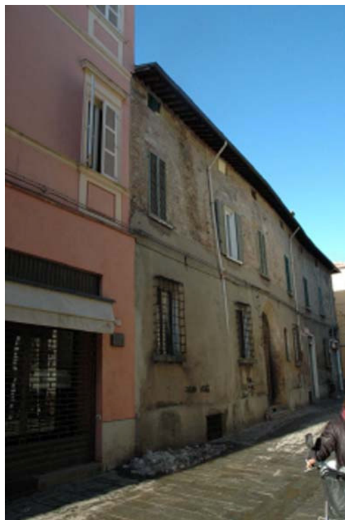
Fig.2: Prospetto di palazzo con ridotta dimensione della cimasa muraria su Via Torricelli
