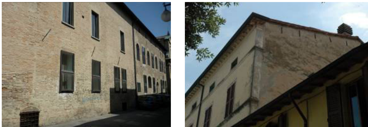
Fig. 15: Esempi di incatenamenti sistematici alla quote di interpiano e di legature metalliche delle orditure dei tetti alla cimasa muraria.
